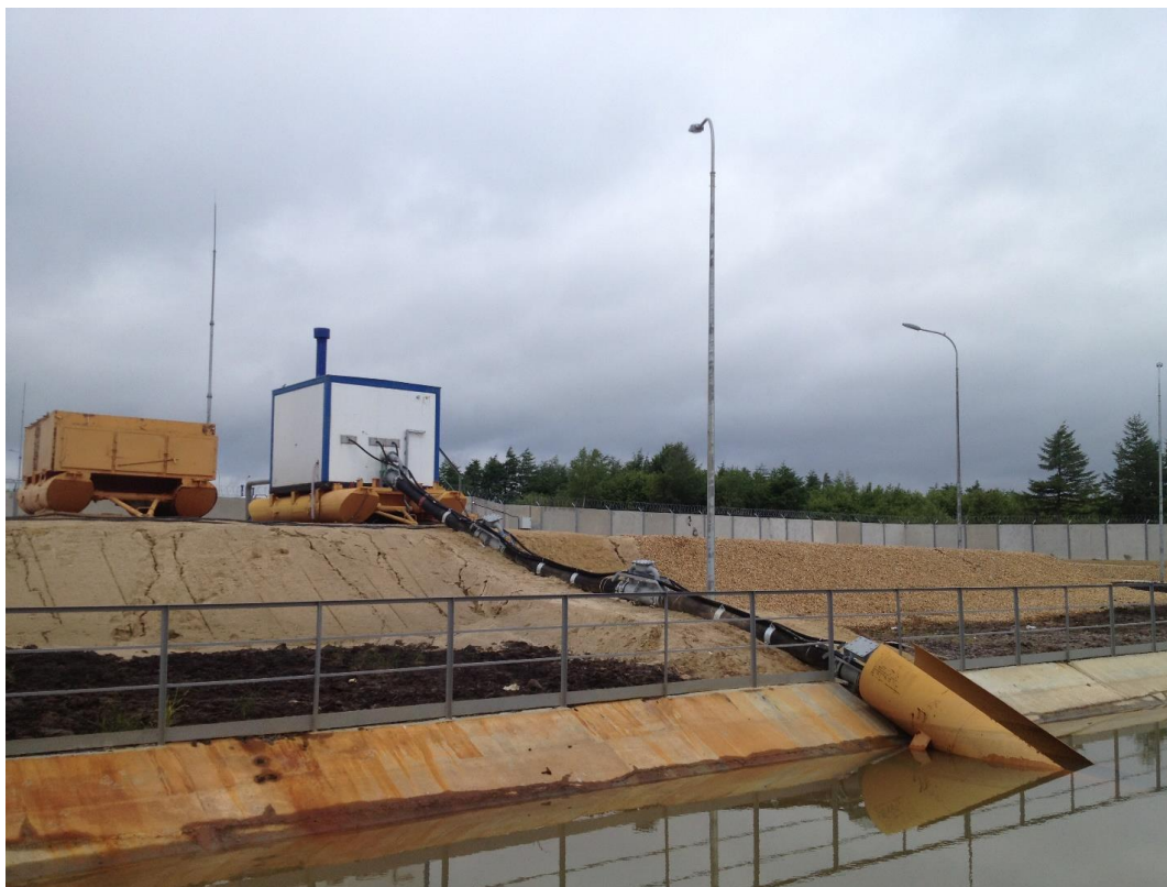
Станция СВ-40 ВЖГ о.Сахалин
