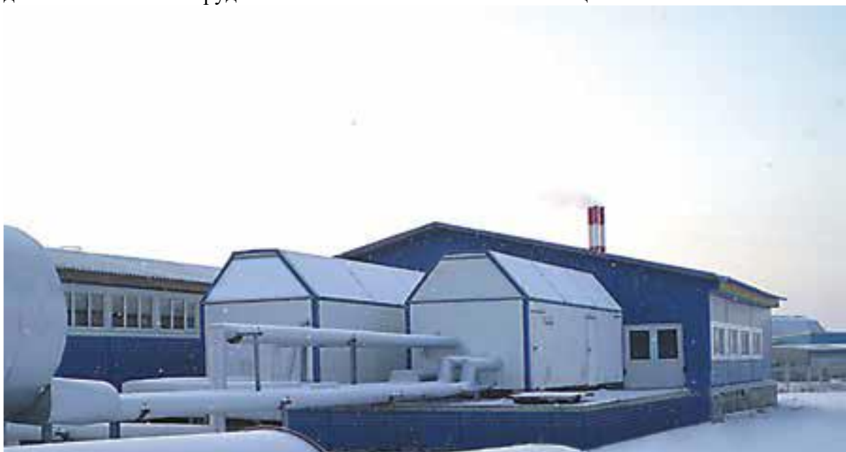
Станции электрокоагуляционной очистки промывной воды «Эко-Водопад-100», Ныдинское ЛПУ, ООО «Газпром трансгаз Югорск»
