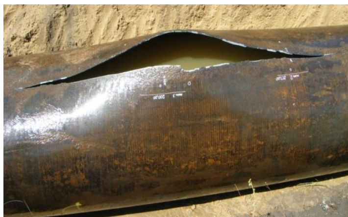
Рисунок 8 – Зона разрушения трубной плети
