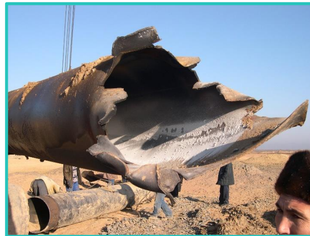
Разрушение магистрального газопровода по причине КРН (Средняя Азия)
