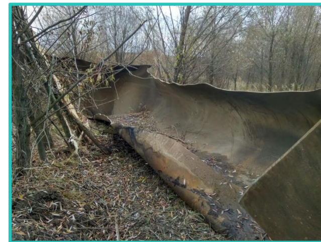
Разрушение магистрального газопровода по причине КРН (Луховицы)
