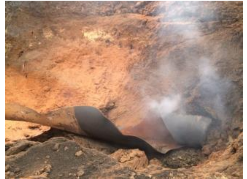
Дефекты КРН на магистральных газопроводах
