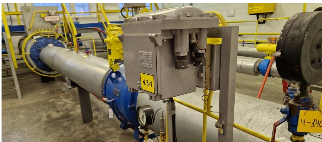
Рисунок 4.4 – Дискретные клапаны-дрессели в составе оборудования блока редуцирования ГРС «Сосногорск»: а) общий вид; б) исполнение линии редуцирования
