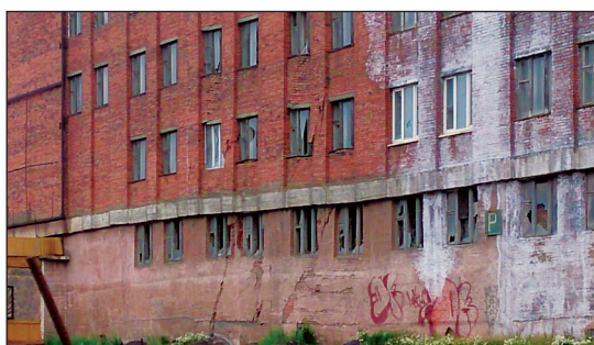
Рис. 3. Пример деформации многоэтажного здания (Норильск, здание Научно-исследовательского института сельского хозяйства и экологии Арктики ФКНЦ СО РАН)
