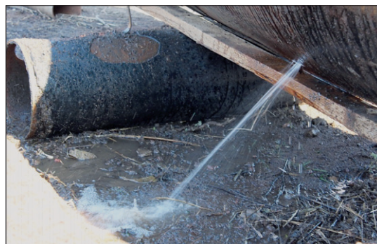
Рис. 3. 100-миллиметровый разрыв образца K2 в продольном направлении с раскрытием шириной 1 мм в зоне участка вздутия
