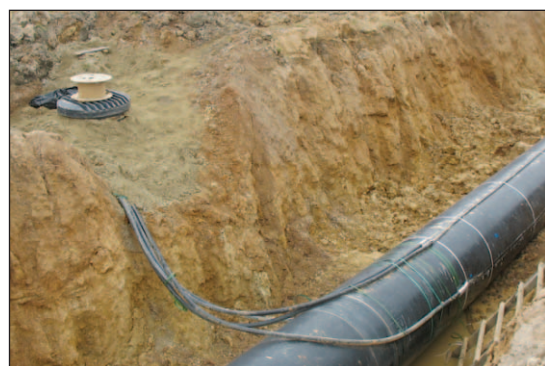
Рис. 5. Оптоволоконные системы контроля напряжений
