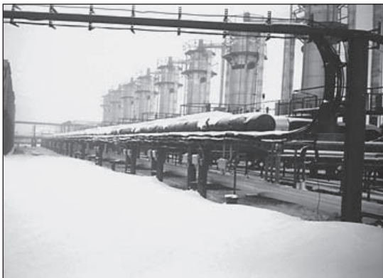
Рис. 3. Внешний вид испарителей, расположенных на площадке СОГ
