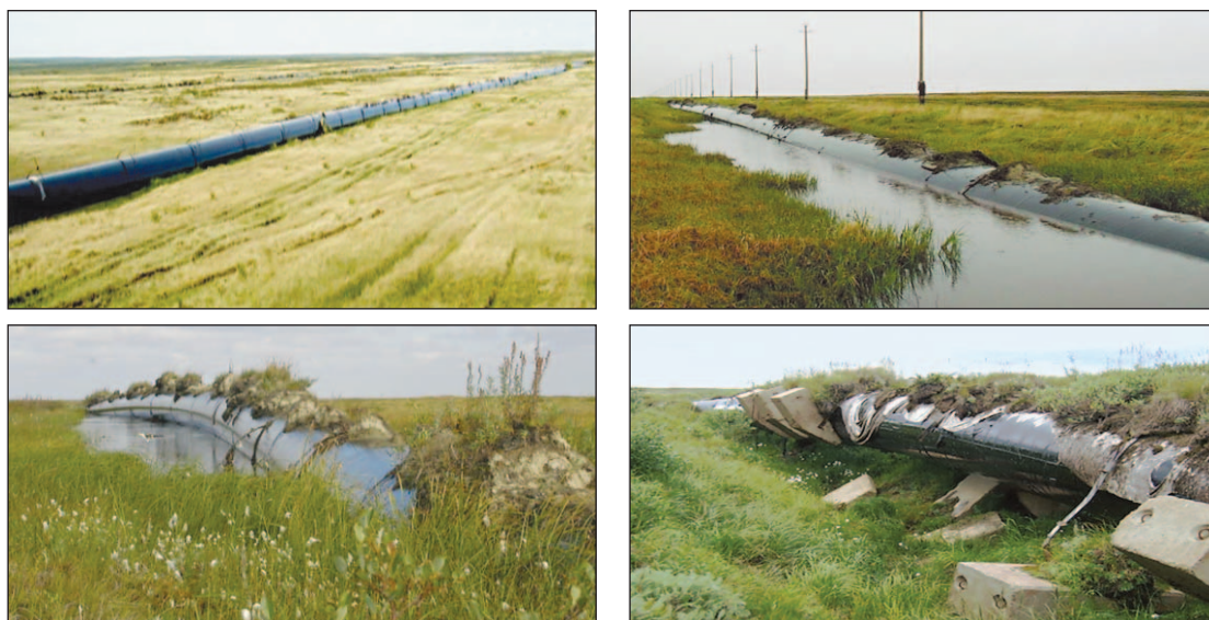
Рис. 6. Нарушения проектного положения газопроводов из-за растепления многолетнемерзлых грунтов
