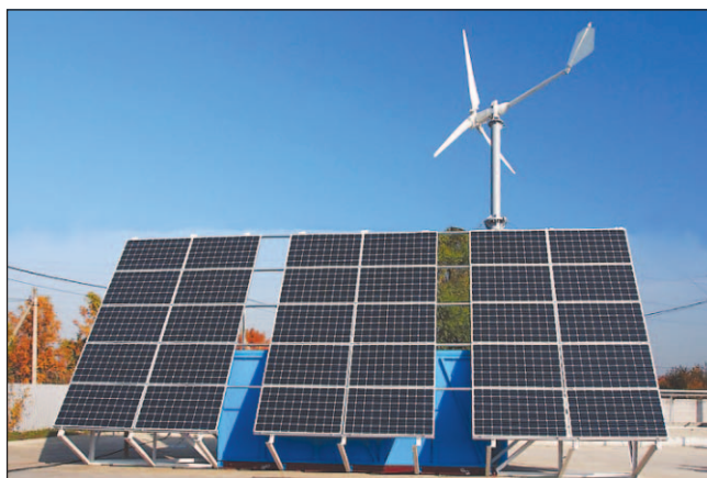
Рис. 7. Автономный источник электроснабжения
