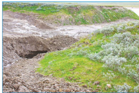
Рис. 15. Водные потоки уходят под поверхность отсыпанного грунта, способствуя размыву засыпки изнутри, 2015 г.
