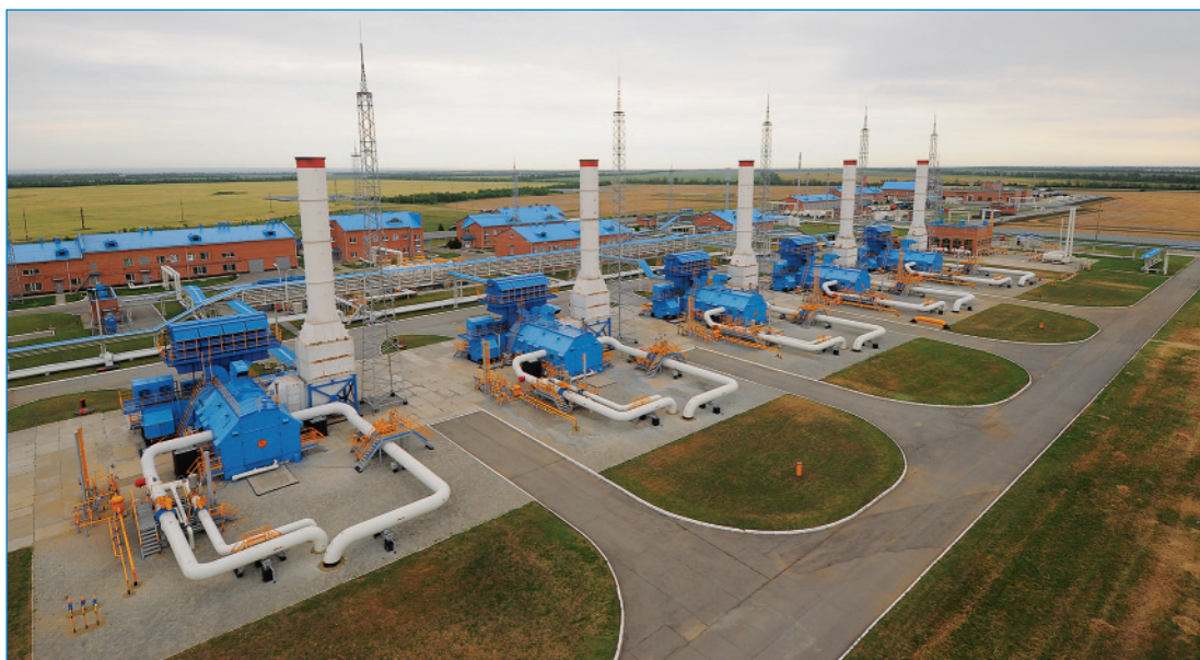
Рис. 3. Общий вид компрессорной станции с газоперекачивающими агрегатами в блочно-модульном исполнении
