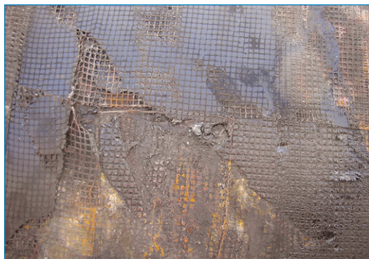
Рис. 10. Повреждения изоляционного покрытия на трубе № 1602 МГ Уренгой – Петровск со следами белого налета на битумной мастике и поверхности металла трубы
