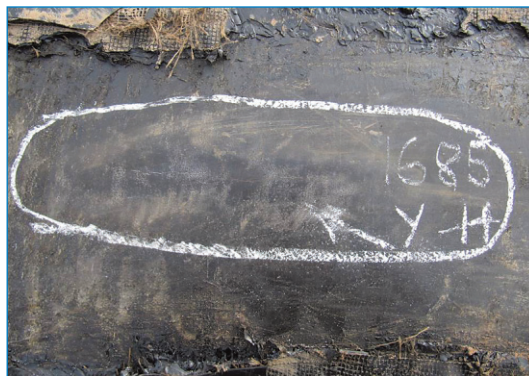
Рис. 11. Зачищенное месторасположение на трубе повреждения КРН, к которому после переизоляции участка не поступал грунтовый электролит
