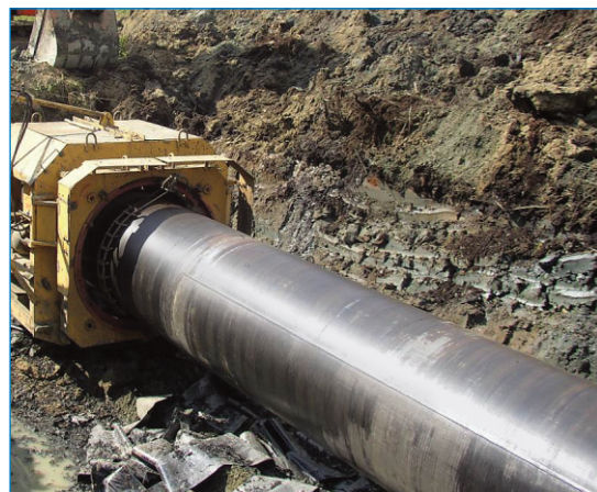
Рис. 9. Белые пятна после снятия изоляционного покрытия при капитальном ремонте на газопроводе в ООО «Севергазпром»
