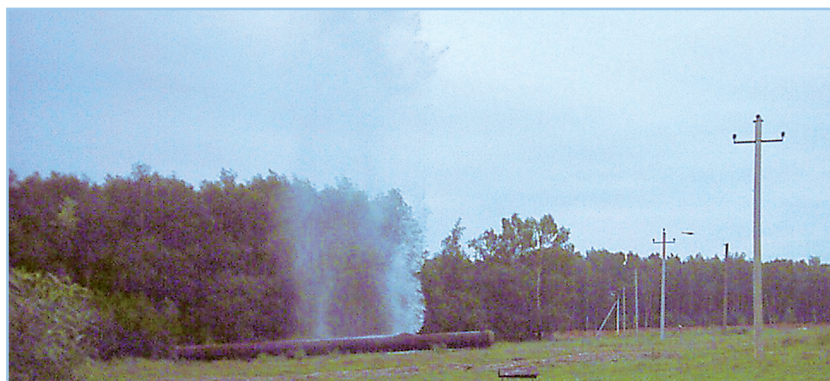
Рис. 2. Разрыв плети трубопровода при проведении экспериментальной опрессовки
