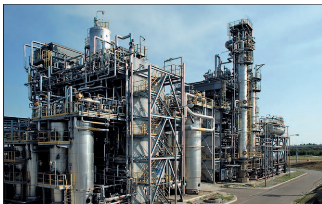
Рис. 4. Сосногорский ГПЗ. Цех по переработке природного газа. Установка низкотемпературного разделения газа
