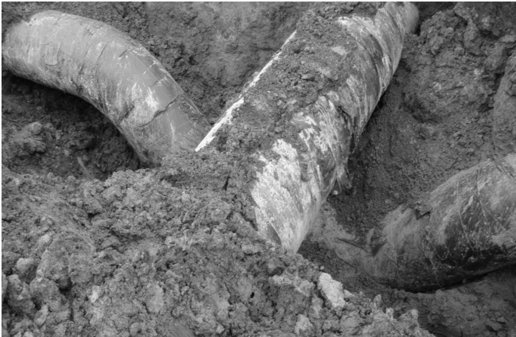
Рисунок 5.18- Пересечение газопроводов с нарушениями нормативных требований
