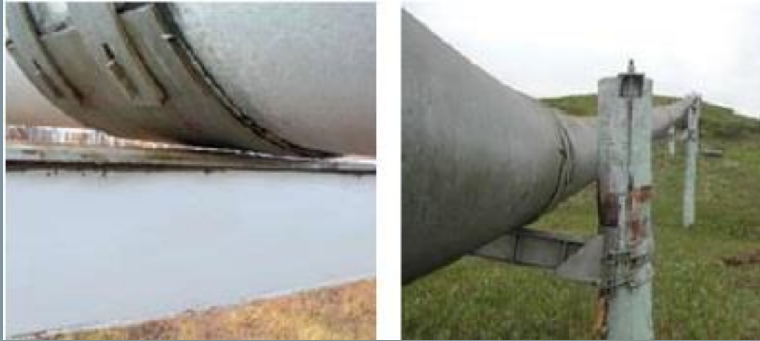
Провисание и наклон ригеля (Рис. 9, 10)
